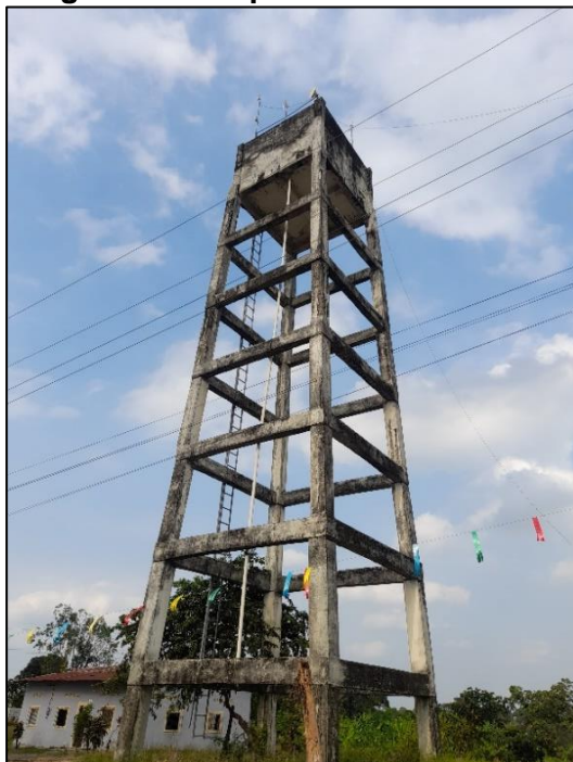
Gráfico 17: Pozo de agua con tanque elevado en el recinto Centinela
