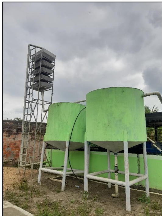
Gráfico 19: Pozo de agua con tanque elevado en el recinto Mesada de arriba
