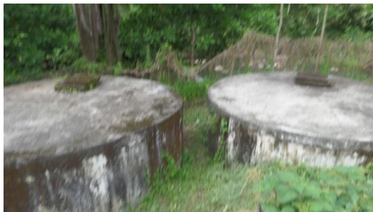
Ilustración 13. Tanques de oxidación en mal estado
