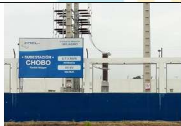
Fotografía 10. Subestación eléctrica Chobo
