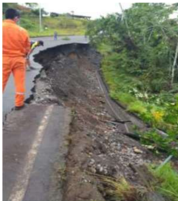
Fotografía 2- 62 : Hundimiento de vía km 85 / Comunidad La Andina Recorrido en campo 2020
