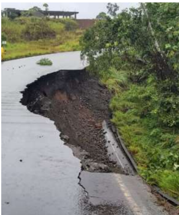
Fotografía 2- 3 Depreciación de mesa km 78 Andina Fuente: Recorrido en campo
