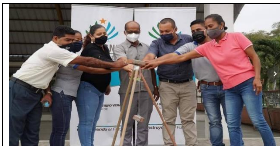
Colocación de la primera piedra proyecto aceras y bordillos de la parroquia Galera
