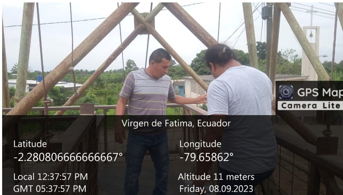
Gráfico 4: Deslizamiento del Puente ubicado en la Vía a Paraiso
