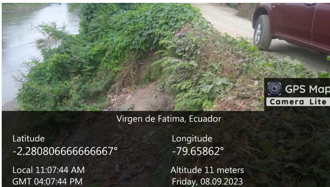
Gráfico 2: Deslizamiento de tierra en la vía al Recinto La Puntilla
