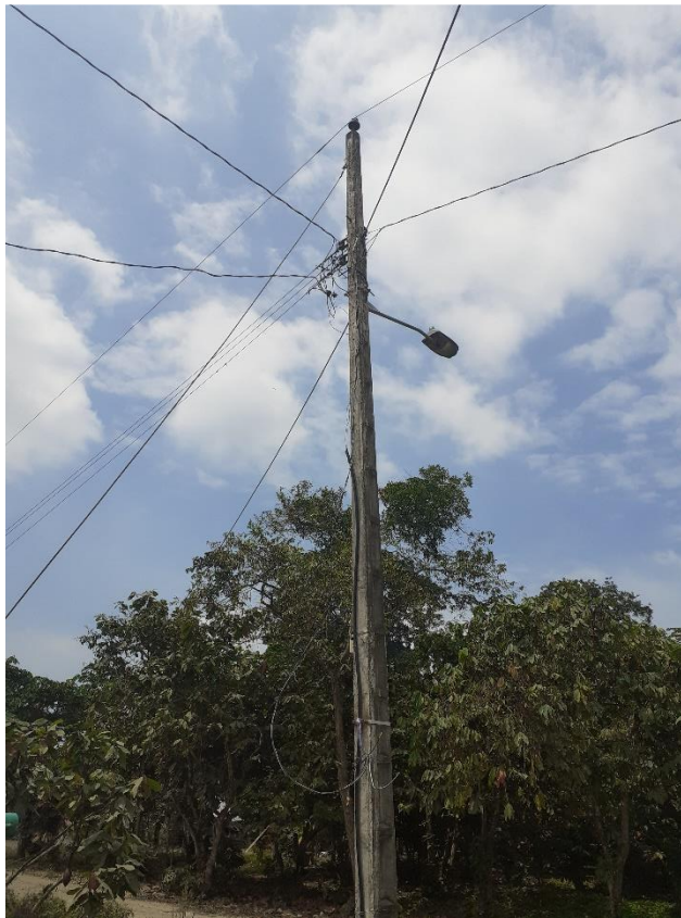
Redes aéreas para el suministro domiciliario
