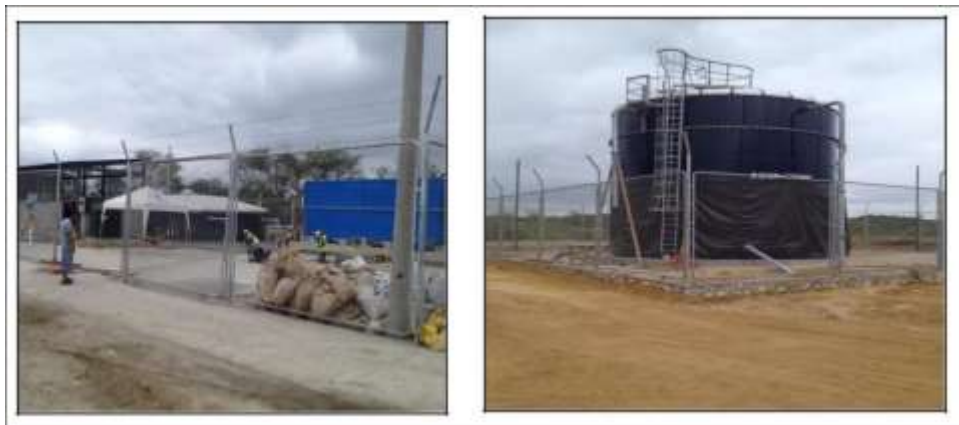
Fotografía 2.- Construcción de estación de bombeo de agua Potable y tanque elevado en el recinto San Lorenzo.
