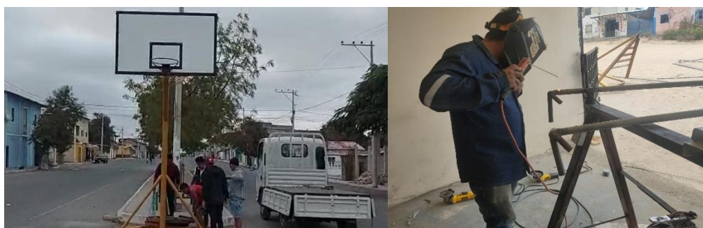
24.- Mantenimiento a las estructuras metalicas en el barrio central de la localidad
