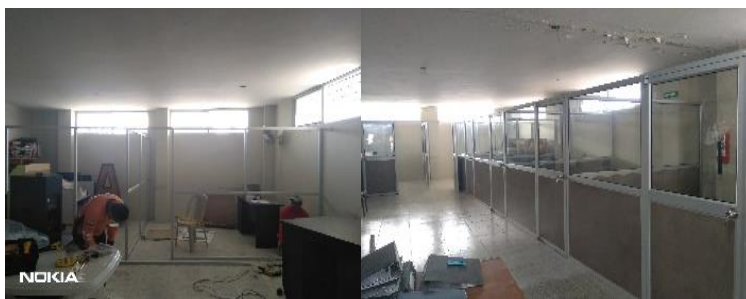
34.-Adecuación a las oficinas de los Vocales e instalación de puntos de red y cableado eléctrico.
