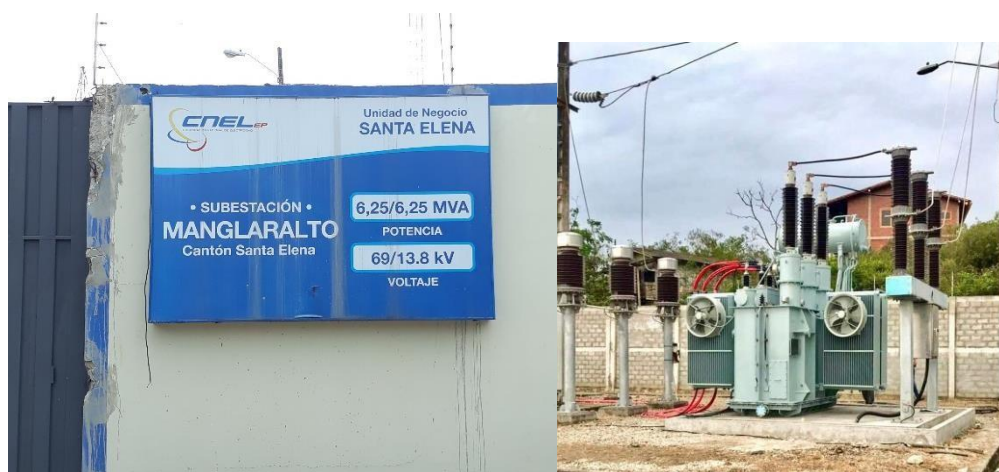
FOTO 25. Subestación de Reducción Manglaralto
