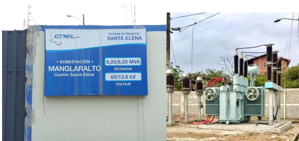
FOTO 25. Subestación de Reducción Manglaralto
