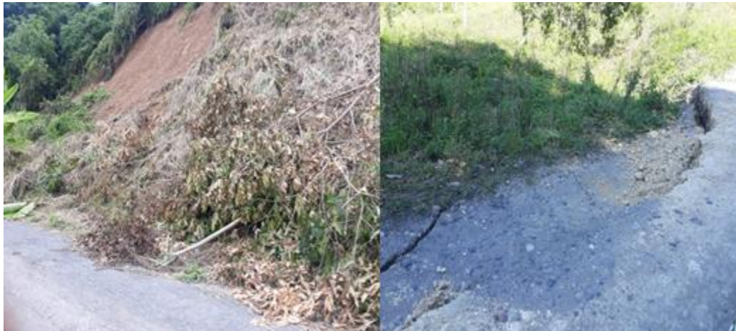
Afectación de laderas en vía Lagarto Anchayacu
