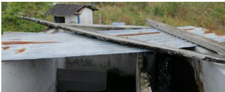
Infraestructura del Tanque nuevo del Sistema de Comunitario de Agua de Lagarto
