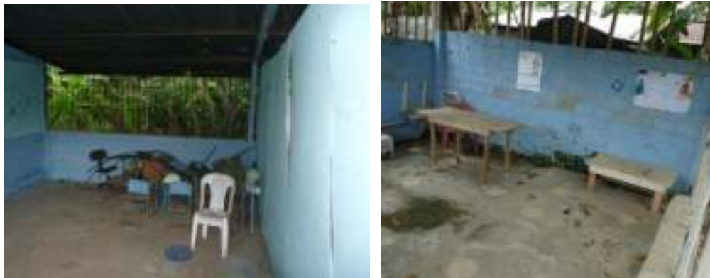
CENTROS EDUCATIVOS CON DEFICIENTE INFRAESTRUCTURA
