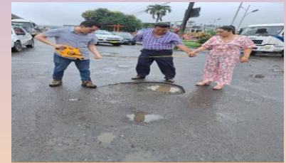
Medición de baches
