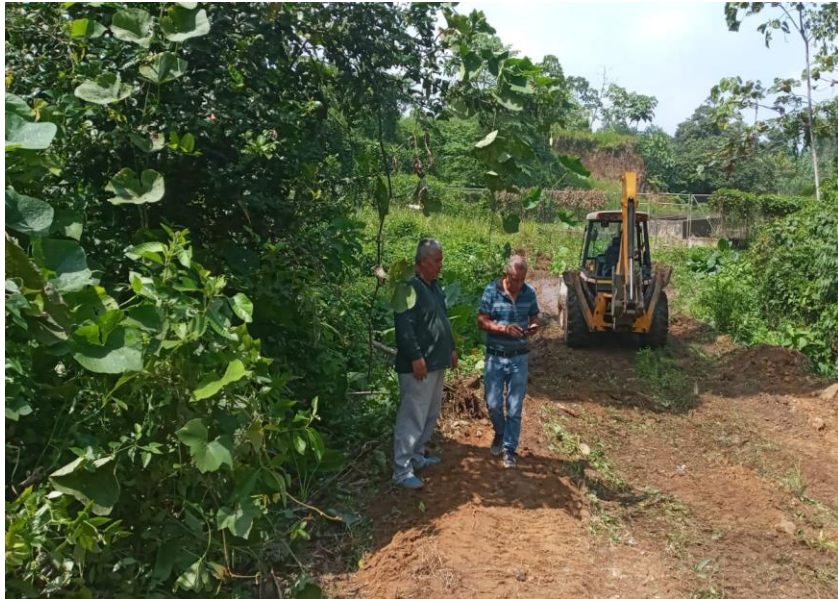
Inspección al mantenimiento emergente de la vía en el Recinto La Primavera
