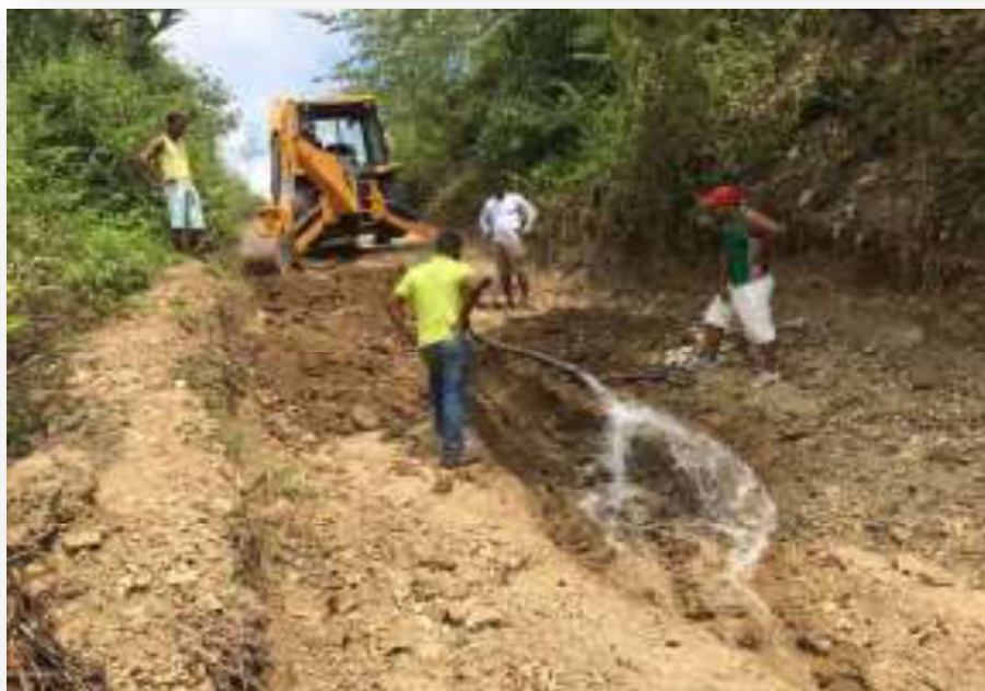
FOTOGRAFÍA 25. MANTENIMIENTO DEL SISTEMA DE AGUA
