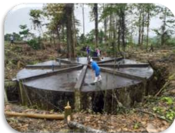
Tanque de reserva agua
