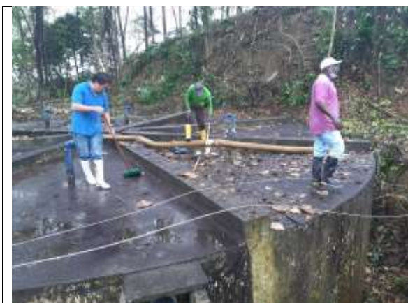
Tanque de reserva toma de agua
