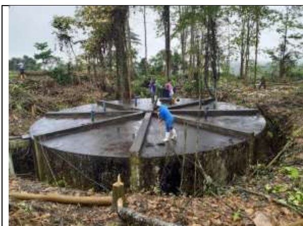
Tanque de reserva agua
