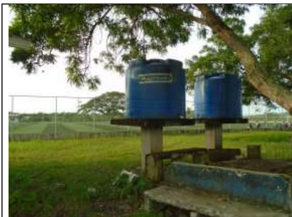
Sistema de agua
